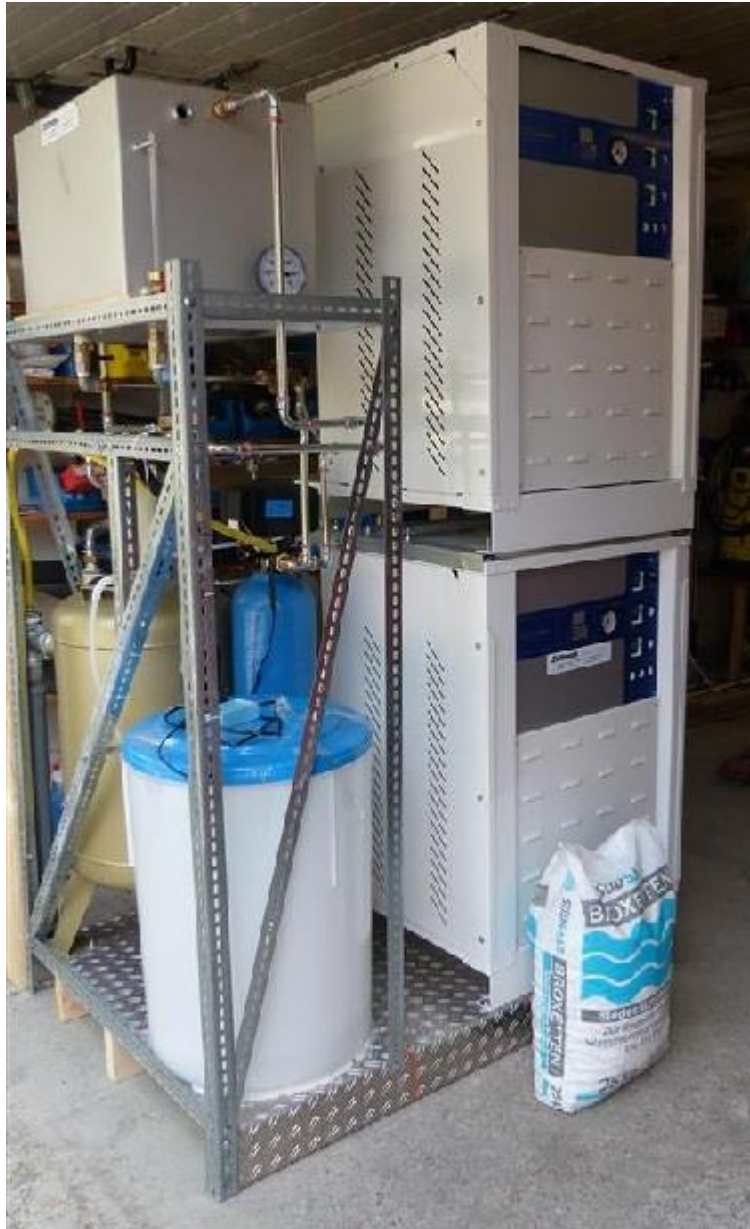
2 x 60 kW, Speisewassertank, Wasserenthärtungsanlage
