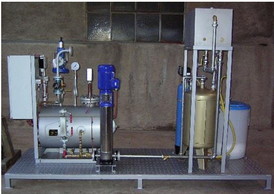
Komplette Anlage mit Dampfdruckminderer mit Speisewassertank, Abschleimmgefäß, Wasserenthärtungsanlage
